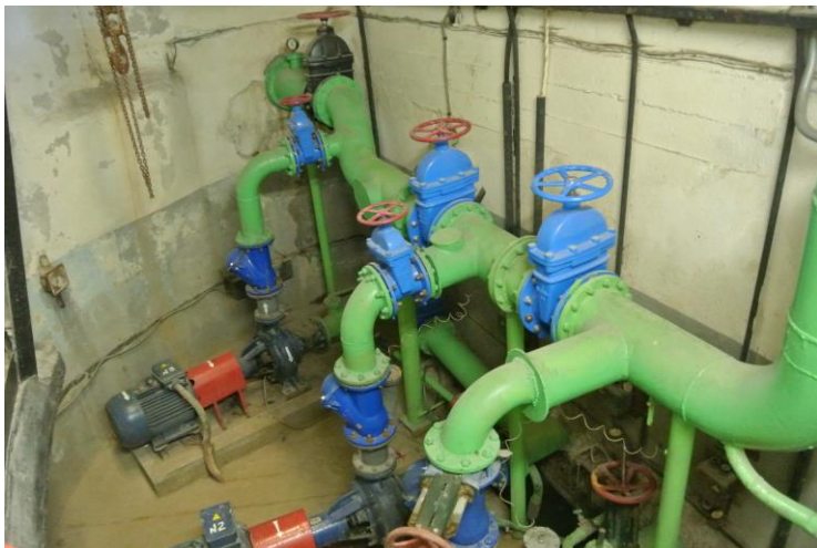
Фото 14. КНС «Псковская», машинный зал
