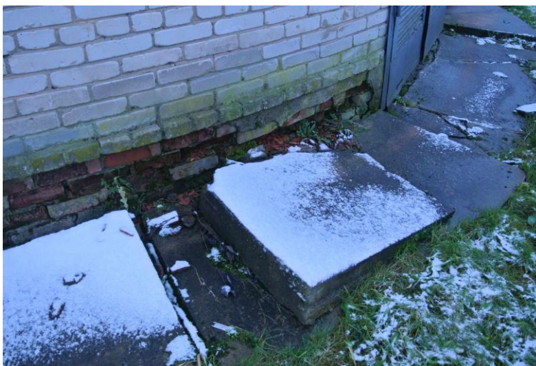
Фото 20. КНС «Байковская», состояние отмостки, наружных кирпичных стен
