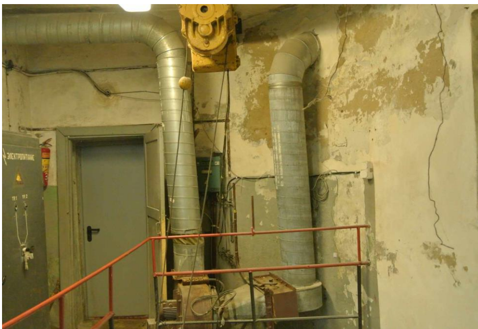
Фото 16. КНС «Псковская», электрощитовая
