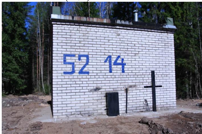
Фото 1. Наземный павильон скважины №14 (№52)
